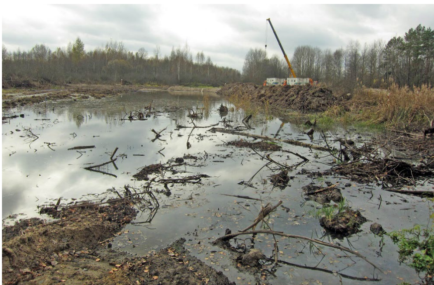
Рисунок 3.5.18 – Залитые водой участки вблизи территории строительства
