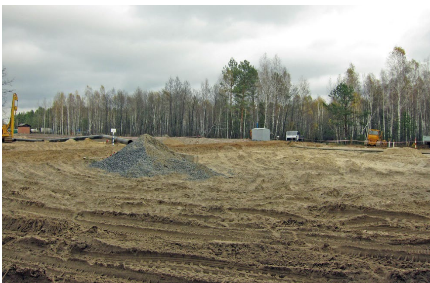
Рисунок 3.5.14 – Уничтоженная в результате подготовительных работ растительность
